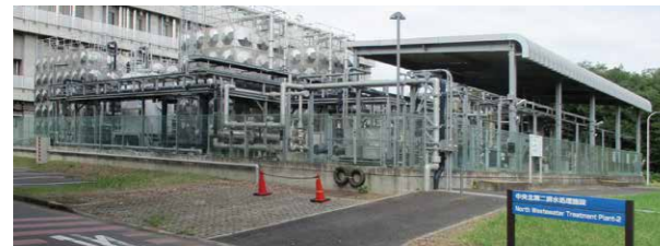
つくばセンター内の廃水処理施設
