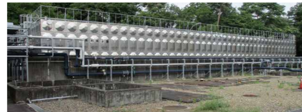
つくばセンター内の再利用水槽
