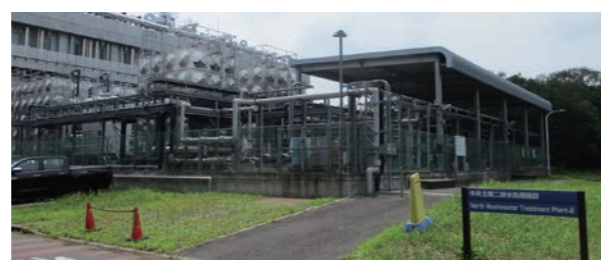
つくばセンター内の廃水処理施設
