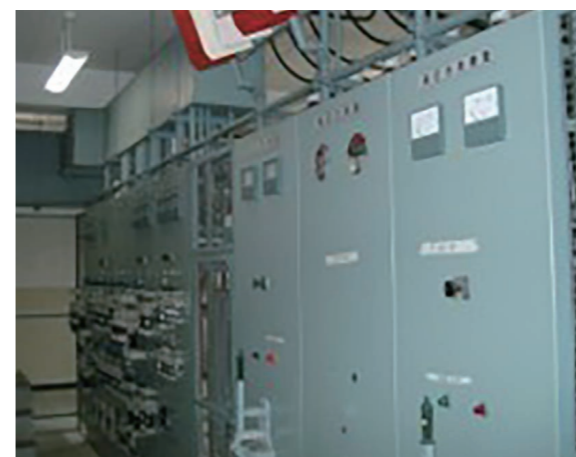
変電設備改修前
