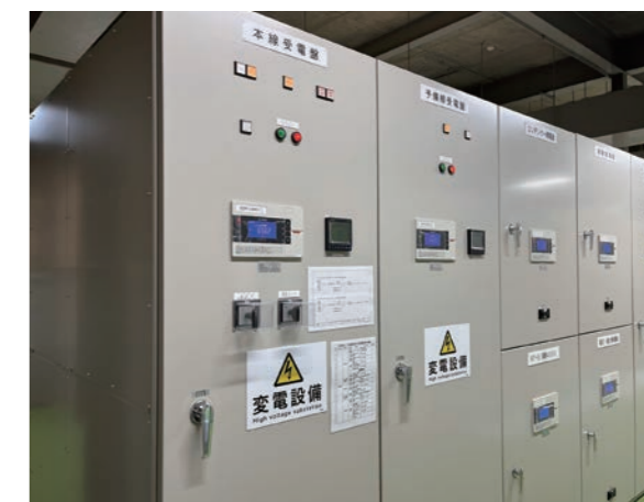
変電設備改修後
