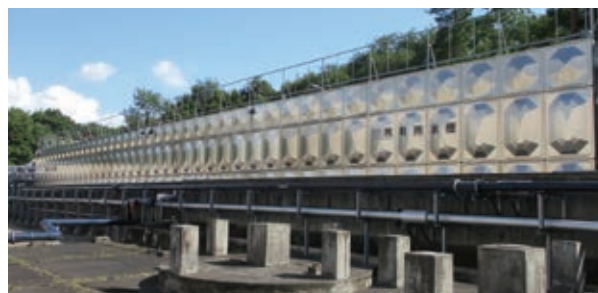
つくばセンター内の再利用水槽
