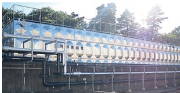
つくばセンター内の再利用水槽
