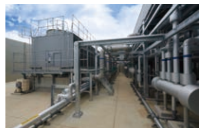
AIデータセンター棟屋外設備 (右がAIデータセンター棟、左が冷却塔)
