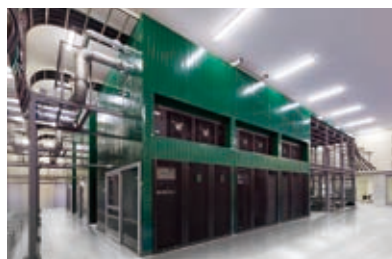
AIデータセンター棟サーバ室内
