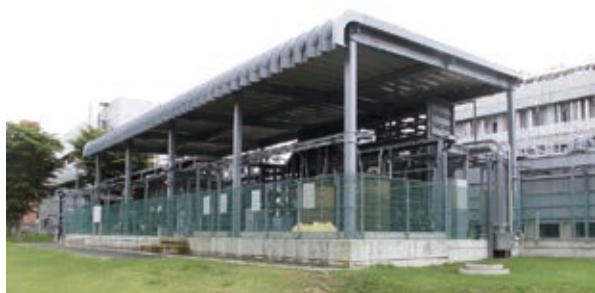
つくばセンター内の廃水処理施設
