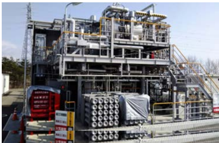
アンモニア合成実証試験装置外観
