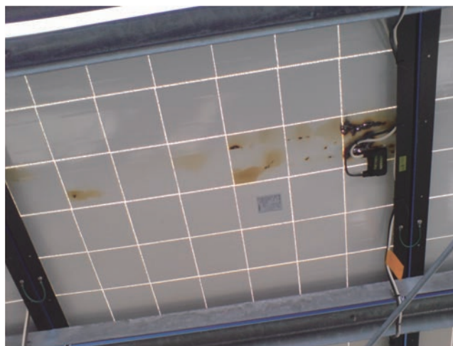
産総研つくばセンターのAISTメガ・ソーラータウンで発生した不具合パネルの例 右端の焼損部の温度は数ヵ月にわたって高温となっていた。
